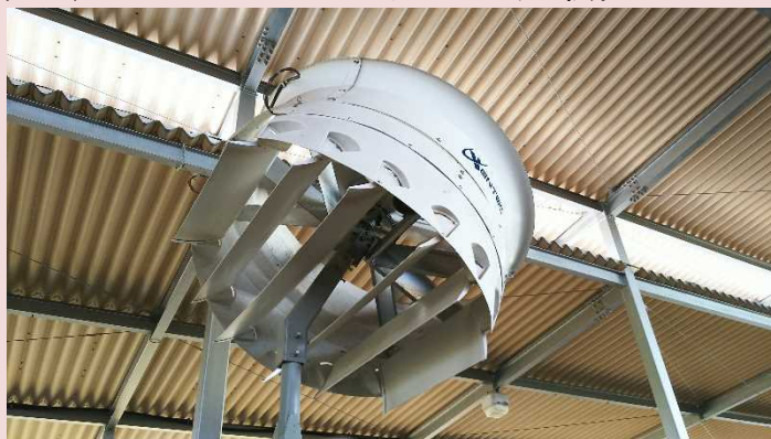
写真4 サイクロン型送風ファンの設置事例（岡山県）
