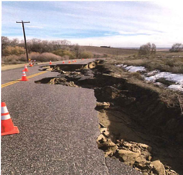
(ワシントン州南部 道路崩壊の状況)
